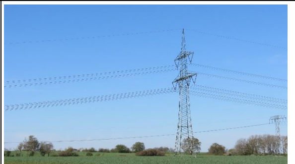
Westliche Blickrichtung auf Tf 3 mit darüber verlaufender 380-kV-Leitung
